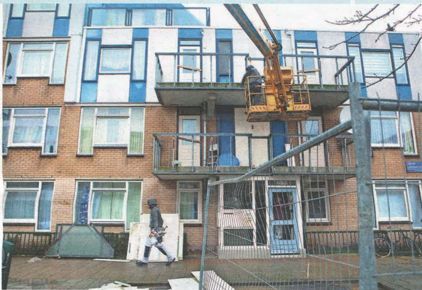
Renovatieproject van Haag Wonen in de Haagse Schilderswijk. Werk aan de balkonnen en vernieuwing van de gevelplaten. Archiefoto: Suzanne van de Kerk
